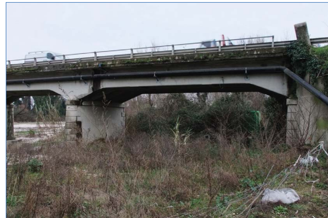
Foto B: Vista del ponte da Ovest con particolare della spalla dx
