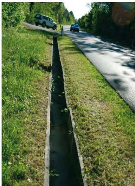
Figura 1 –Canaletta per intercettare gli animali in arrivo dai bordi della strada – particolare tipo.
